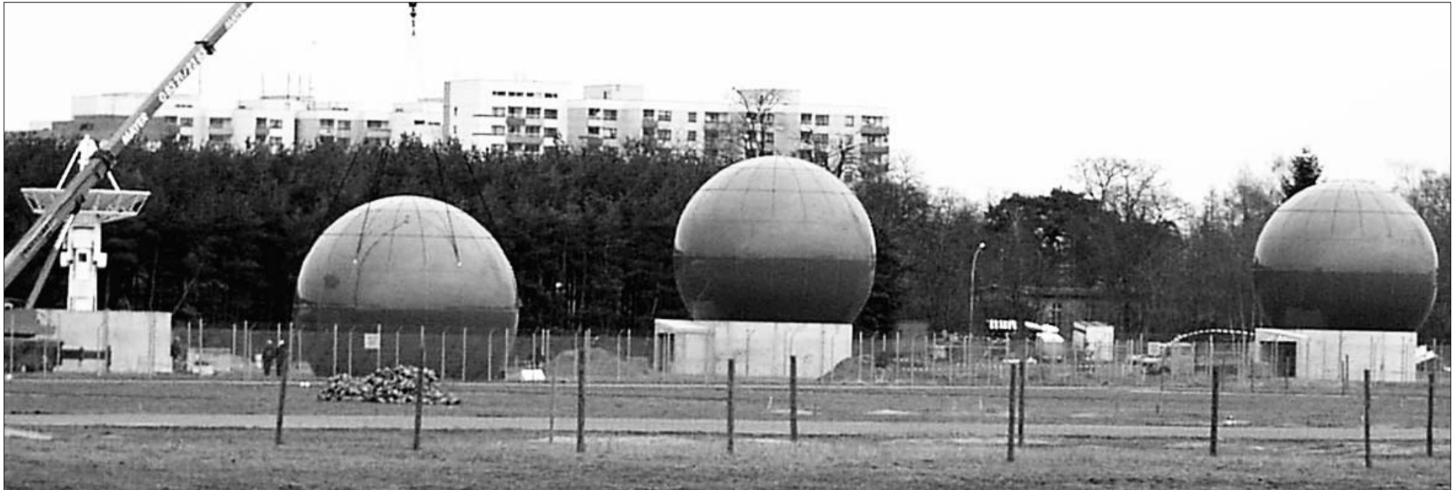
Die „Icebox“ ist in Griesheim. In diesen Tagen begannen die US-Streitkräfte mit der Installation der Antennenanlage auf dem ehemaligen August-Euler-Flugplatz. Zwei der riesigen Schüsseln waren am Donnerstagnachmittag bereits installiert, die dritte Kugel (im Bild links) war noch am Kran befestigt, um über die Parabolantenne gestülpt zu werden (ganz links). Im Hintergrund die Mengler-Hochhäuser. pg-fotos
